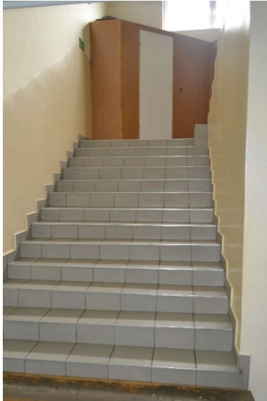
Zdjęcie nr 12: Widok klatki schodowej w miejscu połączenia starej i dobudowanej części Szkoły
